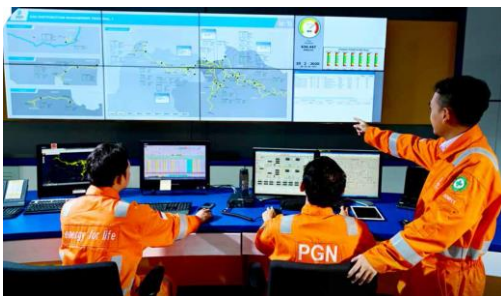
Control room untuk monitoring penyaluran gas. Sumber: PGN 2021
